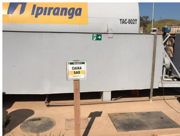
Foto 309 – Caixa SÃO 1 instalada no pátio de manutenção. (Data:09/01/20)
