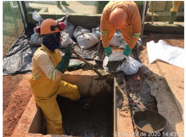
Foto 315 – Registro da caixa AS 2 na área da oficina mecânica no canteiro operacional. (Data:22/04/20)
