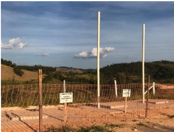
Foto 334 – Sistema de fossa séptica – canteiro operacional. (Data: 17/04/20)
