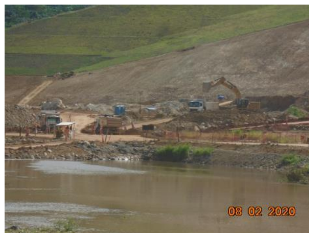
Foto 413 – Movimentação de terra na margem direita, próximo à área do eixo. (Data:08/02/20)
