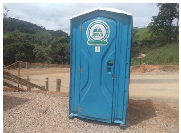
Foto 323 – Banheiro químico instalado na guarita de acesso ao canteiro operacional. (Data:08/02/20)
