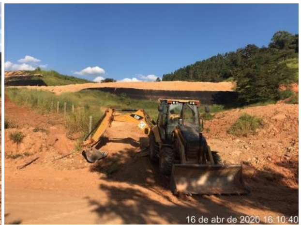
Foto 295 – Conformação de talude após erosões de chuva na margem direita. (Data:16/04/20)
