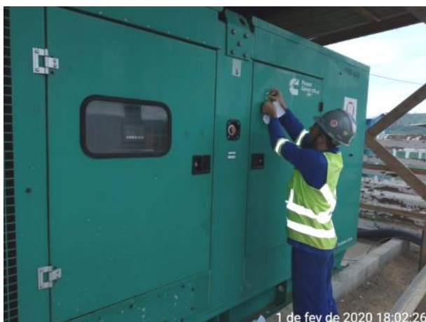
Foto 134 – Inspeção em gerador no canteiro operacionais. (Data:01/02/20)
