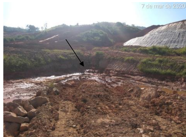
Foto 261 – Drenagem provisória implantada através de cacimbas próximo a área do eixo. (Data:07/03/20)
