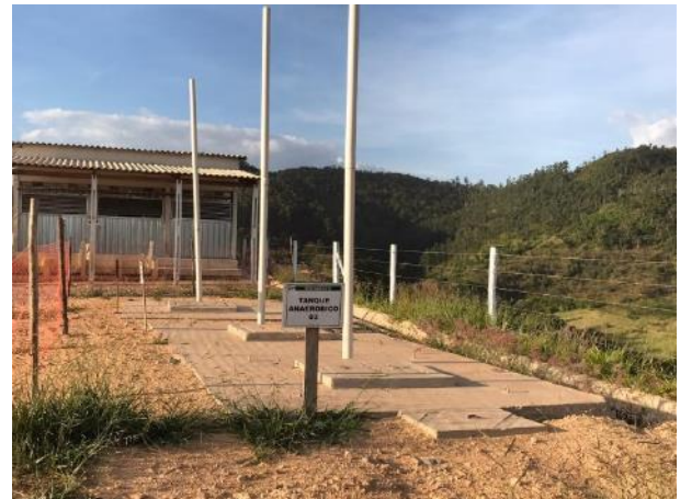
Foto 335 – Sistema de fossa séptica – canteiro operacional. (Data: 17/04/20)
