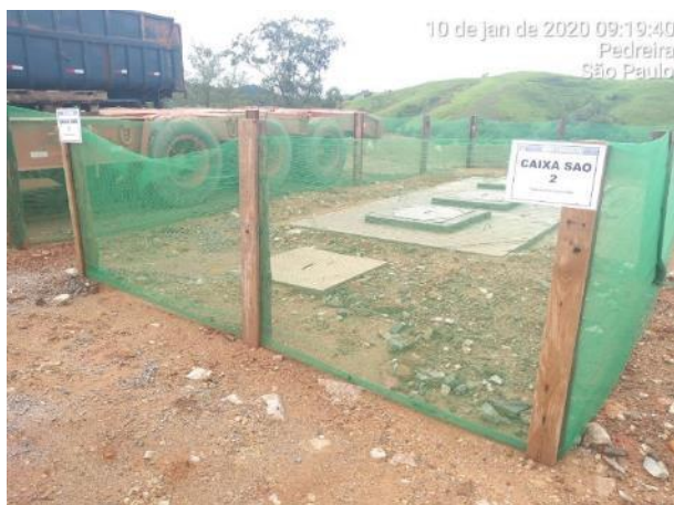
Foto 310 – Caixa SÃO 2 instalada no pátio de manutenção. (Data:10/01/20)
