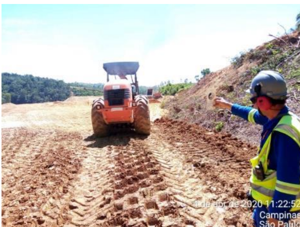
Foto 368 – Inspeção de fumaça preta em equipamento. (Data:04/04/20)
