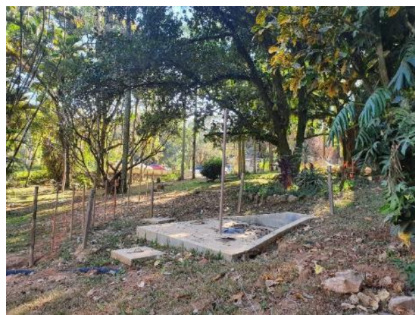
Foto 331 – Biodigestor 2 – canteiro administrativo. (Data: 17/04/20)
