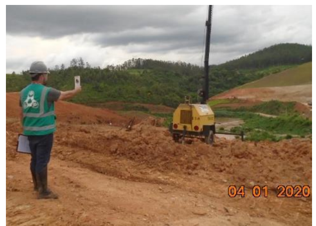
Foto 363– Inspeção de fumaça preta em torre de iluminação – margem esquerda. (Data:02/03/20)
