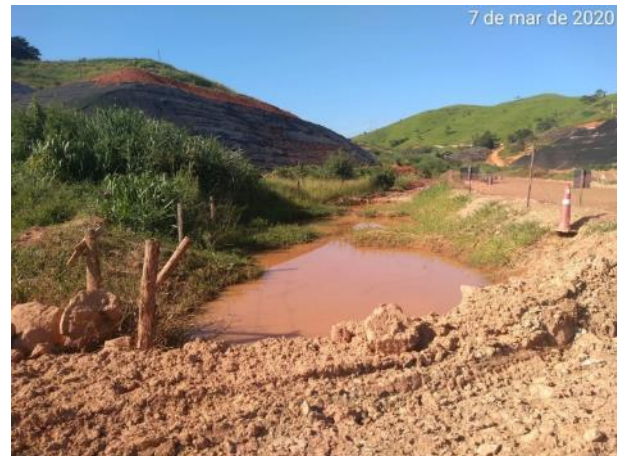
Foto 259 – Drenagem provisória implantada através de cacimbas próximo a área do eixo, margem direita. (Data:07/03/20)
