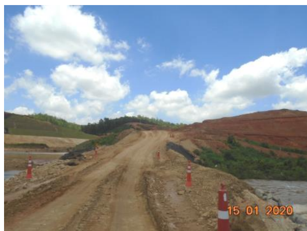
Foto 229 – Sinalização na passagem molhada. (Data:15/01/20)
