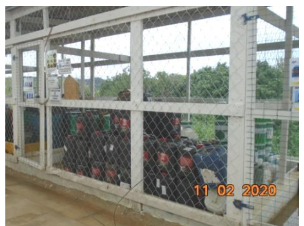
Foto 67– Baía 3 de armazenamento de produtos químicos no pátio de manutenção. (Data:11/02/20)
