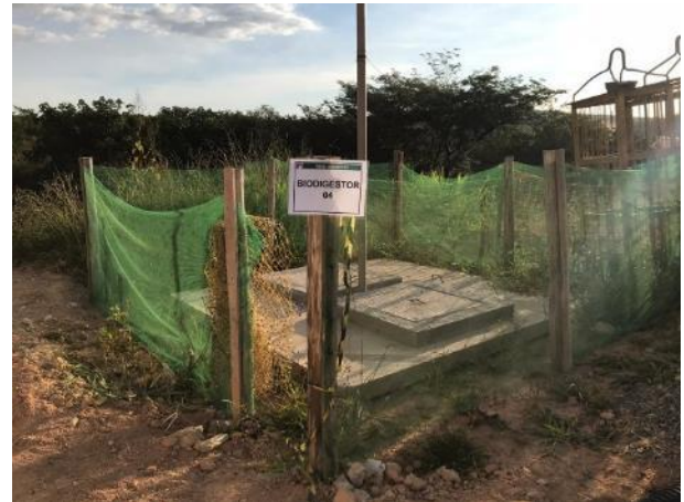
Foto 333 – Biodigestor 4 – pátio de mecânica. (Data: 17/04/20)
