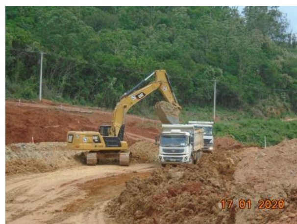
Foto 397 – Movimentação de terra próximo a área do desvio do rio, margem esquerda. (Data:17/01/20)
