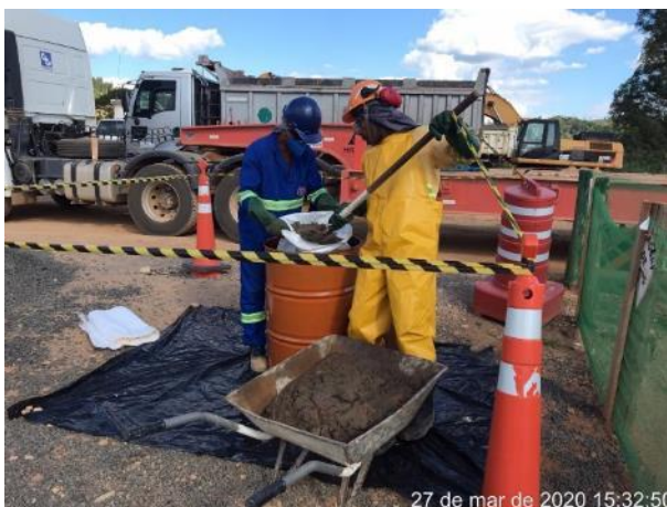
Foto 86 – Solo com óleos retirado durante limpeza da calha da caixa AS. (Data:27/03/2020)
