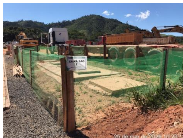
Foto 313 – Caixa SÃO 2 na área da oficina mecânica no canteiro operacional. (Data:25/03/20)
