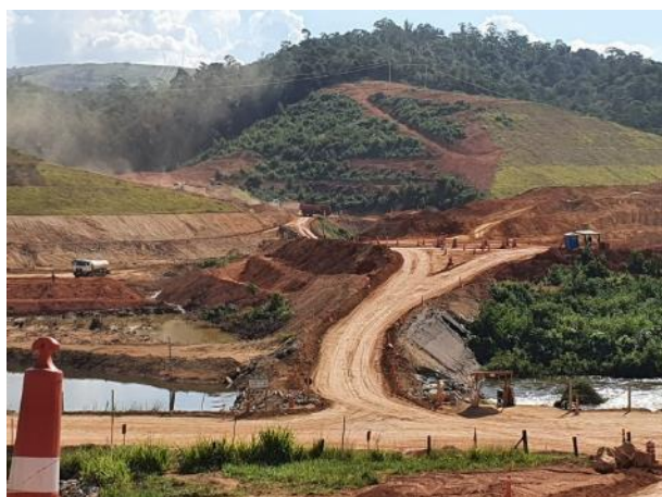
Foto 234 – Sinalização no acesso para enseadeira J0, M0 e canal de desvio. (Data:19/03/20)
