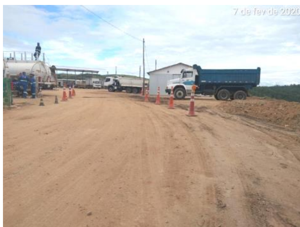
Foto 230 – Sinalização no acesso para área da mecânica. (Data:07/02/20)
