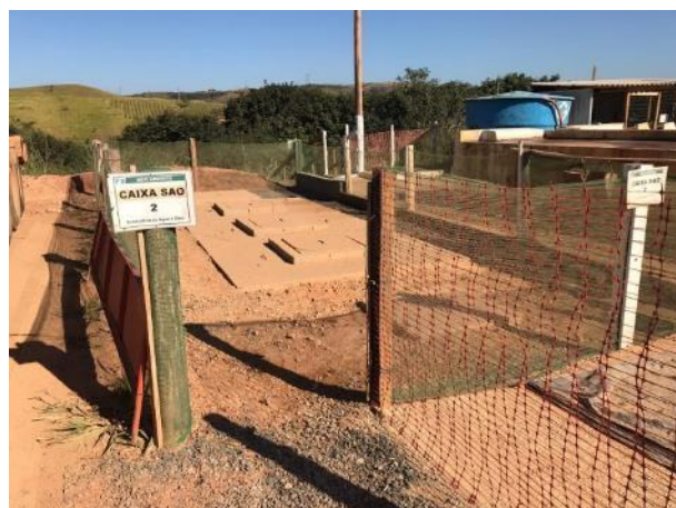
Foto 311 –caixa AS 2 localizada no pátio de manutenção. (Data:13/20/20)
