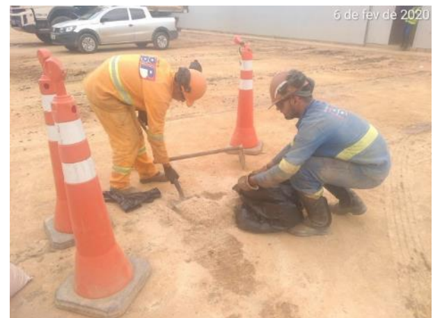
Foto 81 – Profissionais retirando solo misturado com diesel por vazamento de equipamento. (Data:06/02/2020)
