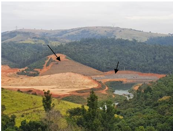
Foto 296 – Talude de corte do canal de desvio, e enrocamento na enseadeira J0 – Margem esquerda. (Data:17/04/20)
