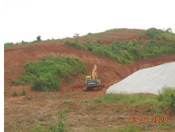
Foto 269 – Conformação de talude após erosões de chuva na margem direita. (Data:13/01/20)
