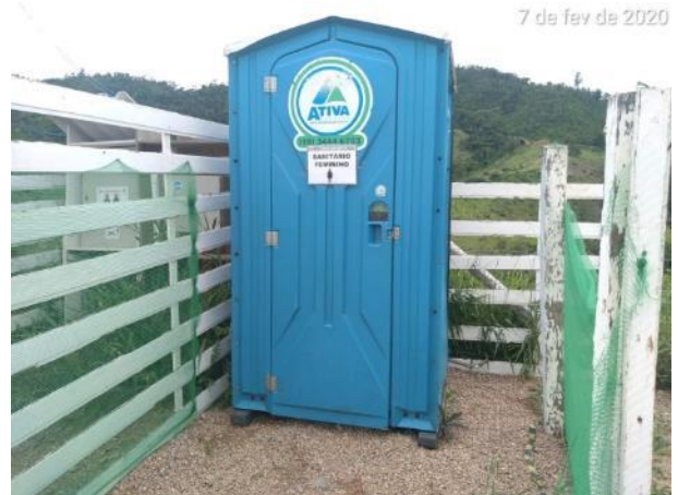
Foto 321 –Banheiro químico feminino no canteiro operacional. (Data:07/02/20)
